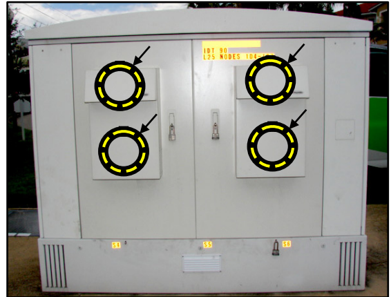
CALIX ODC CABINET (DOOR)
